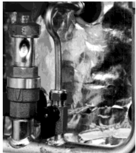
Фото А: Кран заполнения
